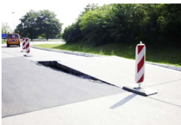
Abbildung 82: Blow Ups bei Fahrbahnplatten aus Beton. Quelle: BASt (2010).
